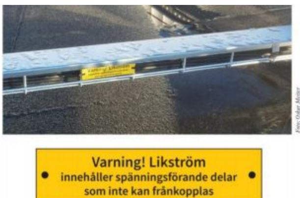
Figur 4. Exempel på utmärkning av dolt förlagd kabel (Svensk Elstandard, 2019).
